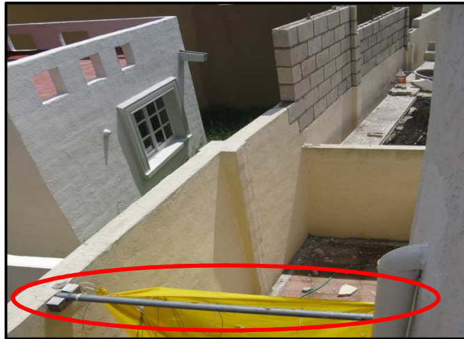
Figura 2.2 Daños en barda
