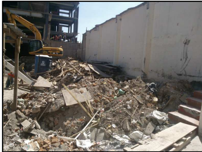
Figura 2.1 Desperdicio de materiales en obra
