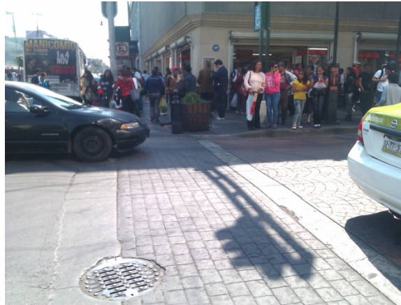
Borde entre el pavimento asfáltico e hidráulico, de la encrucijada de las calles de Hidalgo y Juárez.
