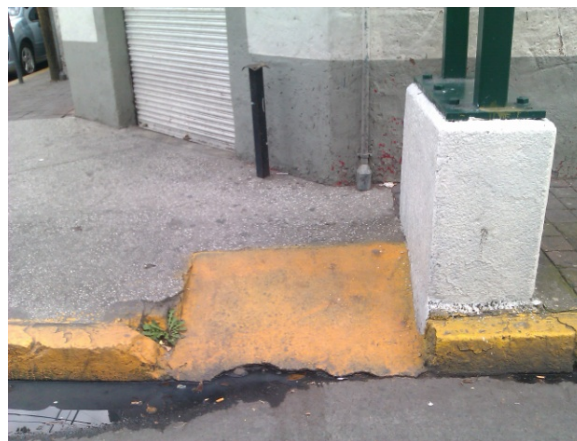
Tipo de rampa diseñado para personas con discapacidad en el Municipio de Toluca, calle de Quintana Roo, zona de la Alameda.
