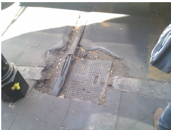
Manguera expuesta en vialidad sobre el cruce de peatones, representa un riesgo para el peatón, ubicada en Juárez esquina Hidalgo.
