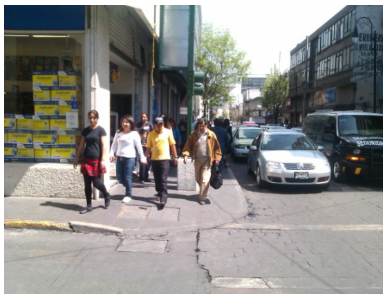
Desnivel presente en las banquetas, Calle Hidalgo esquina Galeana.
