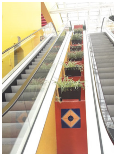
Escaleras eléctricas dentro del Centro de Convenciones. Fuente: Foto JECL, 2019.
